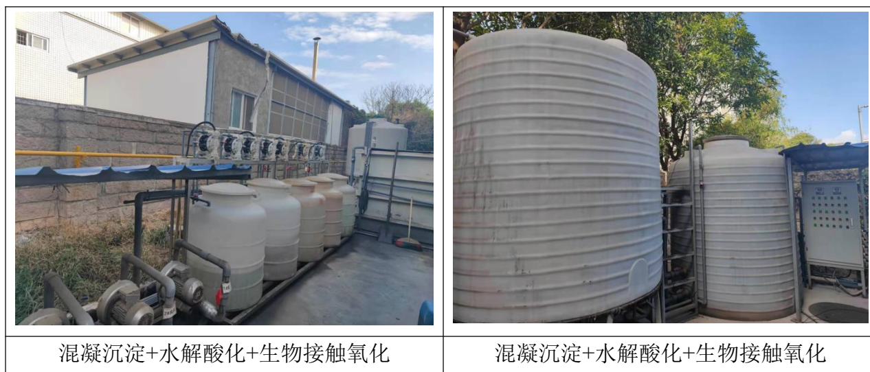
图 3.1 废水处理设施配套情况
